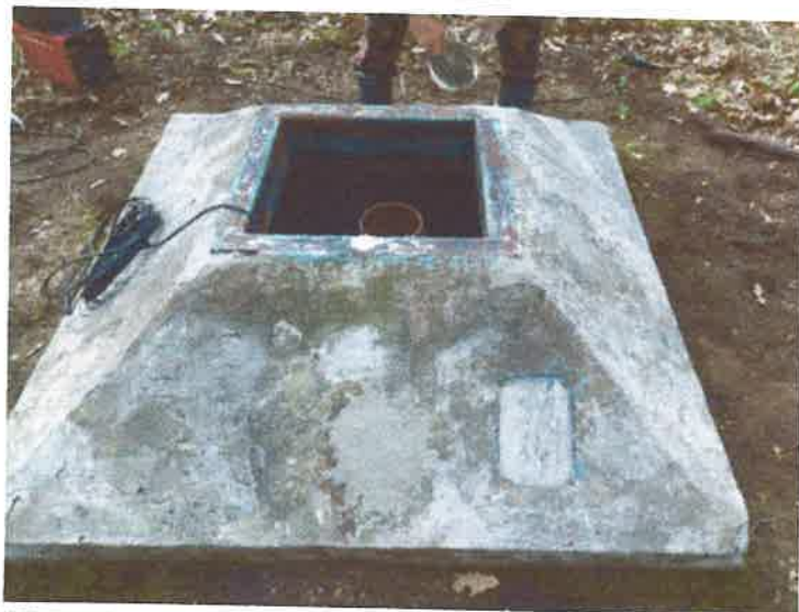
Javítás és a felújított állapot:
