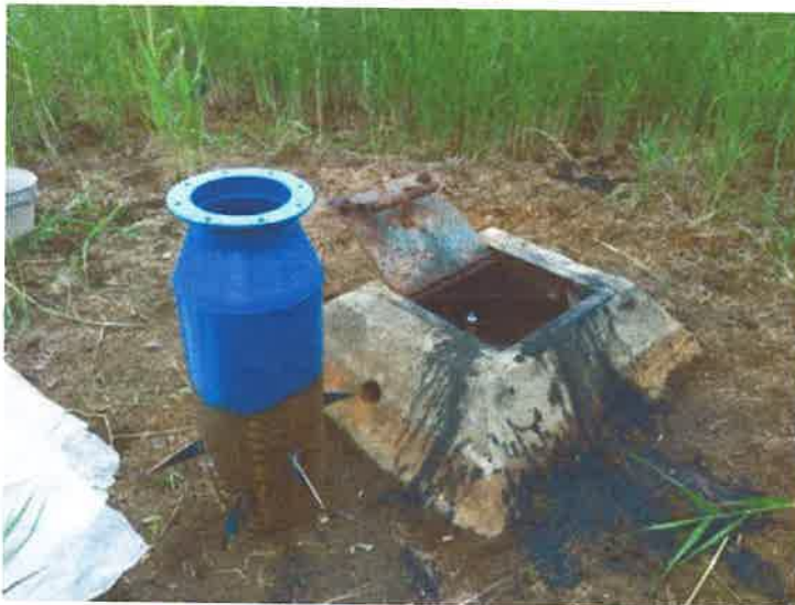
Javítás és a felújított állapot:
