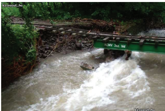
9. ábra. A kisvasút tönkrement hídja
