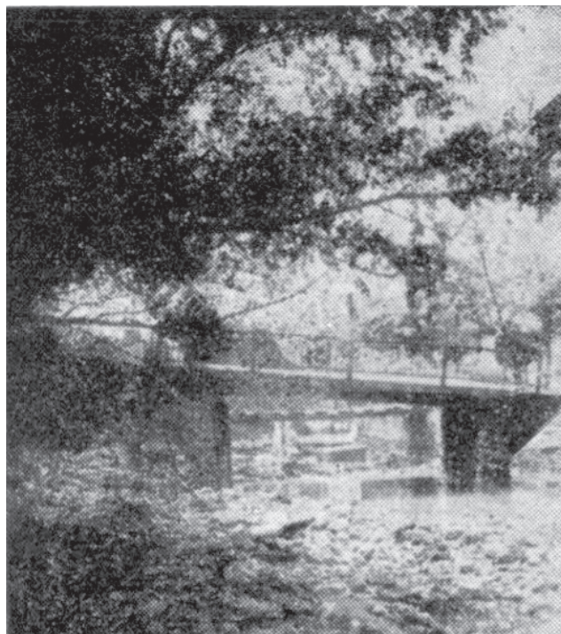
2. ábra. Az árvíz elmosta a vasútállomásra vezető út hídjához csatlakozó töltést
