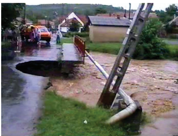
7. ábra Megrongálódott híd Bernecebarátiban
